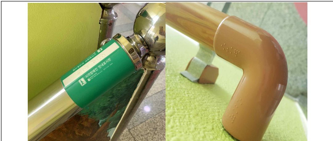
[그림 5-5] 시각장애인 점자 안내표시판이 설치된 계단 손잡이와 보조 손잡이
